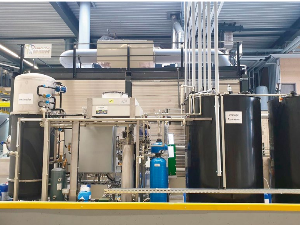
Die Waschkabine verfügt über einen Abluftwäscher und eine Verdampferanlage – dadurch arbeitet die Anlage komplett abwasserfrei.
