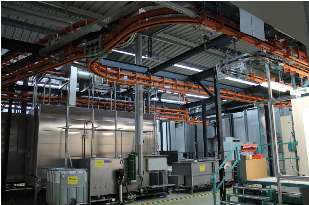
Nach Aufnahme der Bauteile durch eine Hub-Senk-Station befördert die P+F-Fördertechnik mit drei Meter langen Traversen sie Richtung Vorbehandlung.
