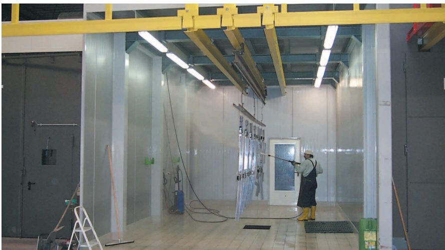
Einfaches, robustes Fördersystem: Der Querverschub könnte auch elektrifiziert werden
