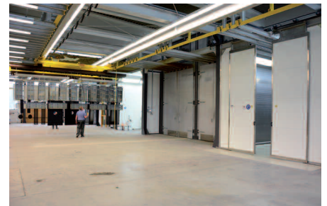
Die Querbühne wird für den senkrechten Transport vor die Kabinen elektrisch und für den Quertransport in die Kabinen manuell bedient. Die Anlagentechnik von rechts nach links: Washkabine, Haftwassertrockner, Einbrennofen, Pulverkabine und Nasslackierkabine.
