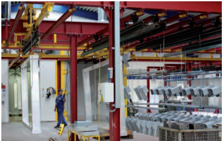
▲ Die Kompaktheit der Jumbo Coat Anlagen kommt nicht zuletzt durch die genial einfache Förderung zu Stande. Die rechtwinkligen Richtungsänderungen vermeiden Platzverluste durch Kurven
