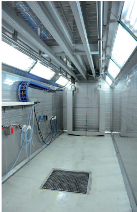
Die Vorbehandlung umfasst für die Aluminiumteile die Prozessschritte Beizentfettung, Spülen 1, Spülen 2, VE-Spüle und Passivierung.
