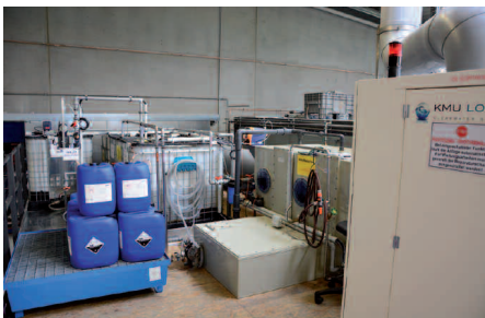
Die Aufbereitung des Abwassers erfolgt über einen Vakuumverdampfer.
