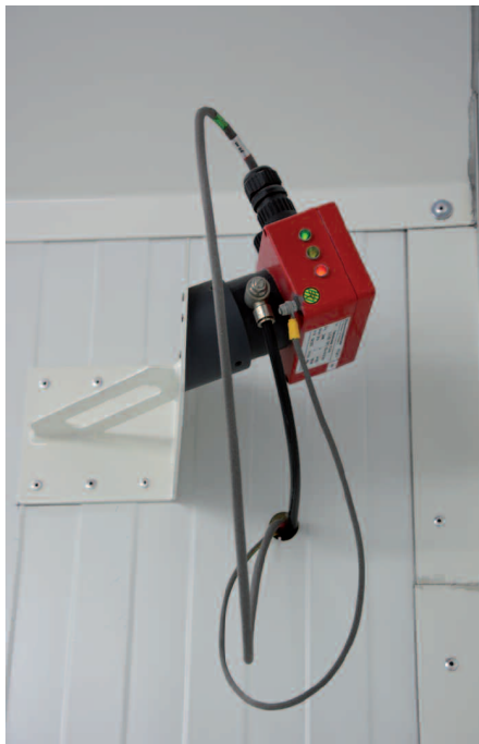
Die Pulverkabine ist mit einer Brandunterdrückungsanlage ausgestattet. Im Fall einer Funkenentwicklung löst die Überwachung u.a. die Löschung mit CO 2 aus.
