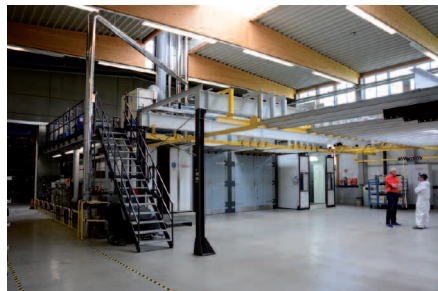
Die Anlage im Überblick, von links: Vorbehandlung, Haftwassertrockner, Einbrennofen, Pulverkabine. In der 2. Ebene befinden sich die Technik für die Vorbehandlung und die Abluftanlage.
