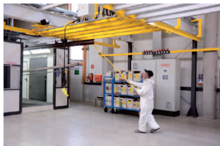
Die Übergabe der Traversen in die Querfahrbühne erfolgt manuell, die Bewegung der Querfahrbühne elektrisch.
