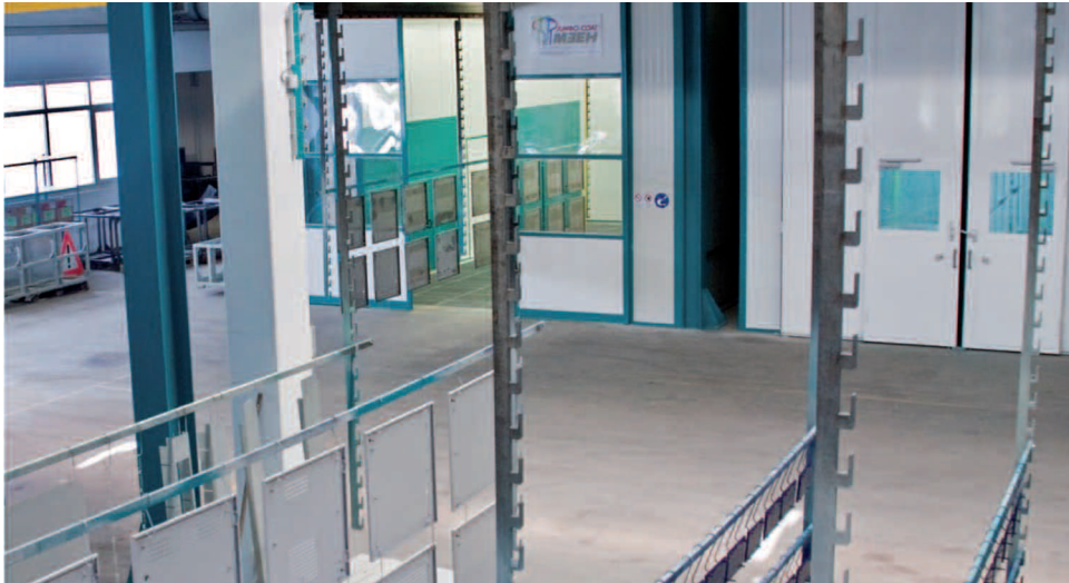
Eine Querfahrbühne und Schiebetüren an den JUMBO-COAT-Kabinen sorgen für ein kompaktes Anlagenlayout.
