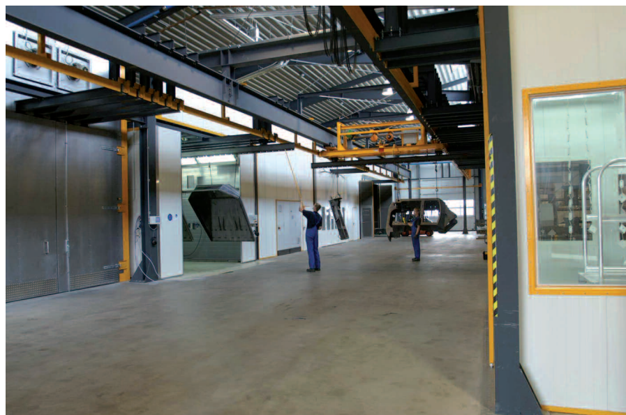
Die Anordnung der Kabinen ähnelt einem „H“. Links: der Einbrennofen, die Waschkabine, das Lacklager, die Nasslackierkabine und die Strahlkabine. Rechts die Pulverkabine. Dahinter befinden sich die Pufferplätze für Warenträger.
